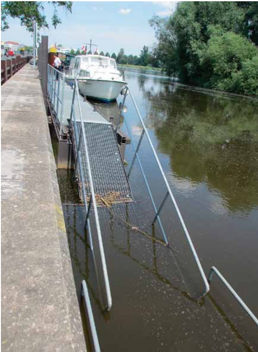
Le ponton d'amarrage flotte. Mais l'accès est sous l'eau
