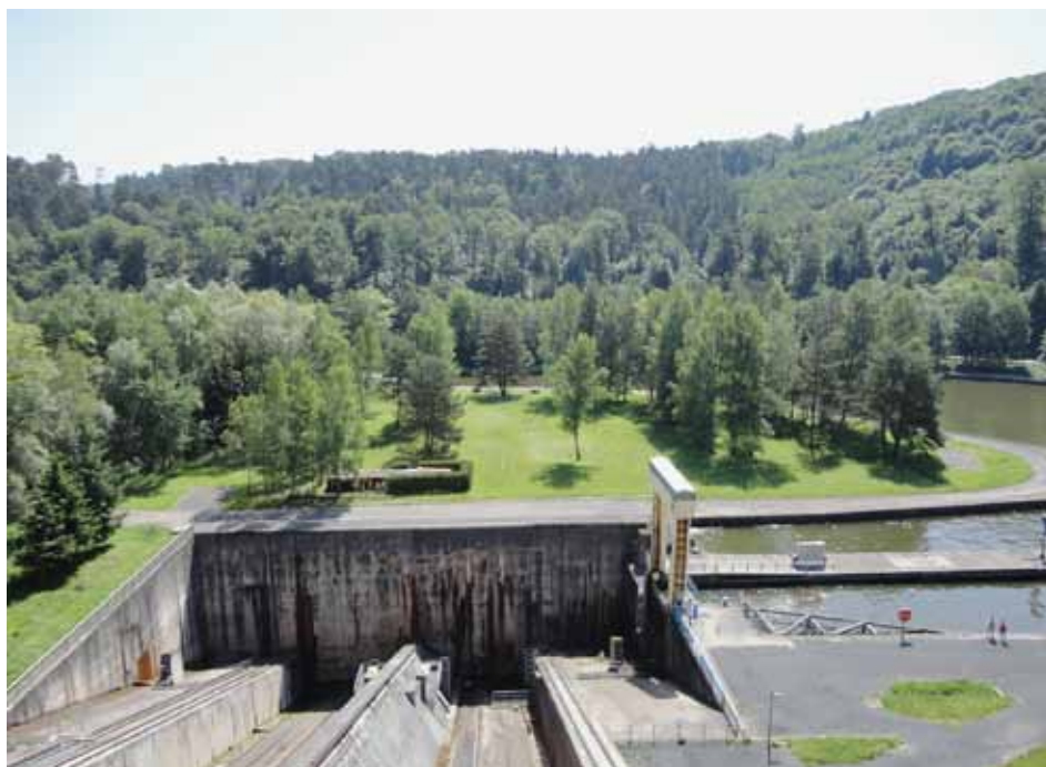
...hier krachten nach dem Unfall stundenlang grosse Wassermengen hinunter
