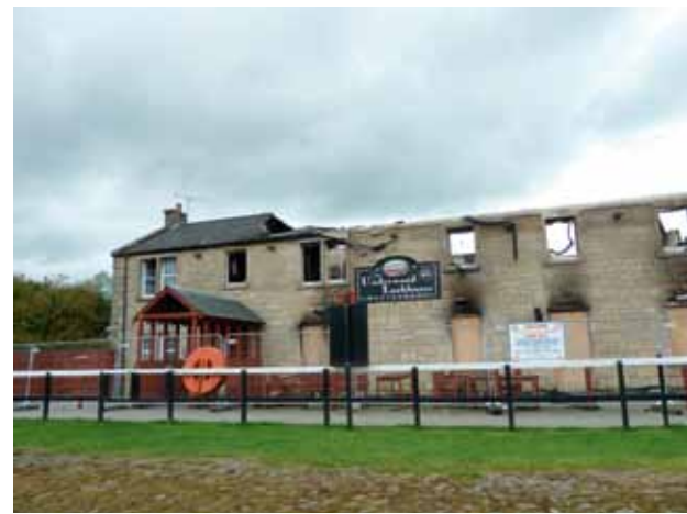
Das sah vor zwei Jahren noch anders aus. Nun streiten sich die Eigentümer mit der Versicherung. – Am Forth &amp; Clyde Kanal
