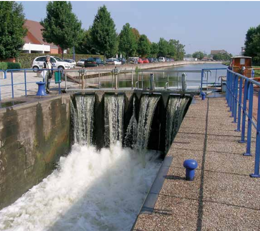
Für die Reparatur einer Schleuse weiter oben wird das Wasser eines ganzen Kanalabschnittes abgelassen
