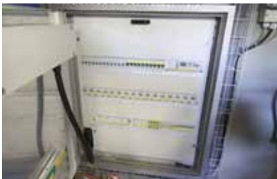
Schaltschrank im Maschinenraum
